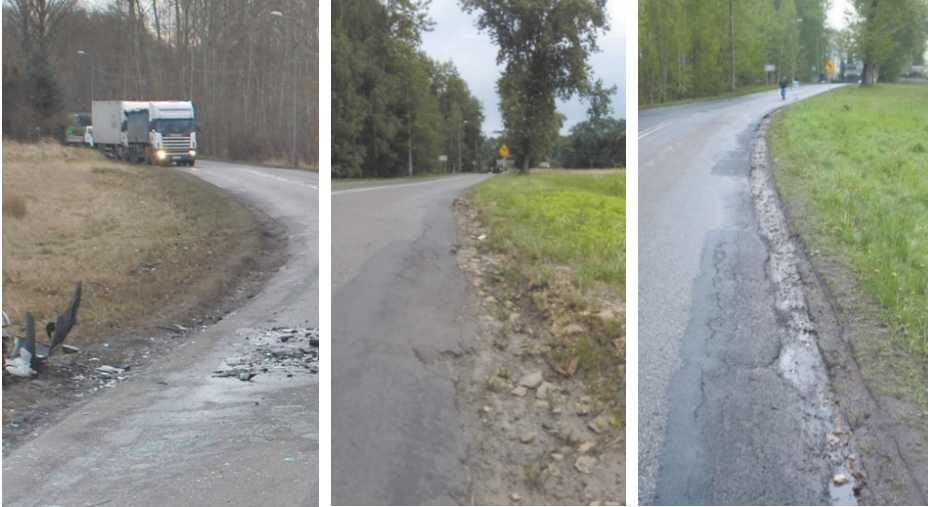
Ryc. 6. Stan wewnętrznej krawędzi jezdni na zakręcie. Od lewej: zdjęcie wykonane bezpośrednio po wypadku, zdjęcie wykonane przez kierowcę samochodu Kia jakiś czas po wypadku, zdjęcie wykonane w czasie eksperymentu.
